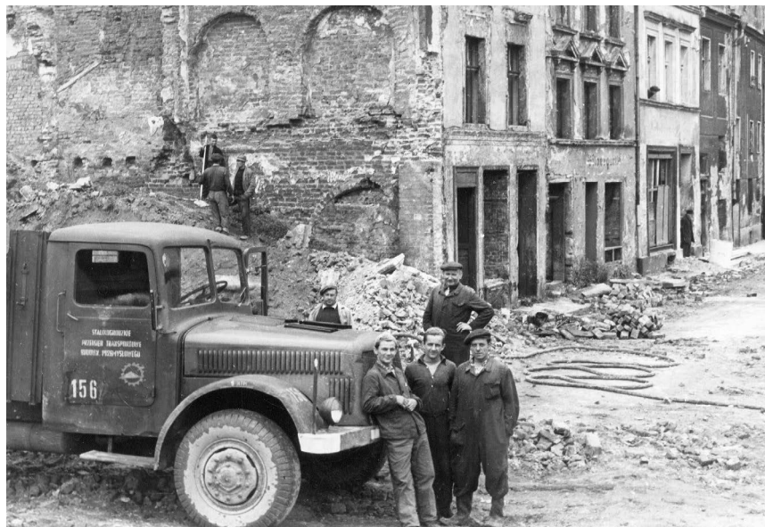
II.21. Prace rozbiórkowe w śródmieściu, 1953–1956 r. Podstawą datowania jest widoczny na zdjęciu samochód ciężarowy Stalinogrodzkiego Przedsiębiorstwa Transportowego Budownictwa Przemysłowego. Źródło: PŚJ. Ruiny, lata 50. [?] XX w., b.a.
