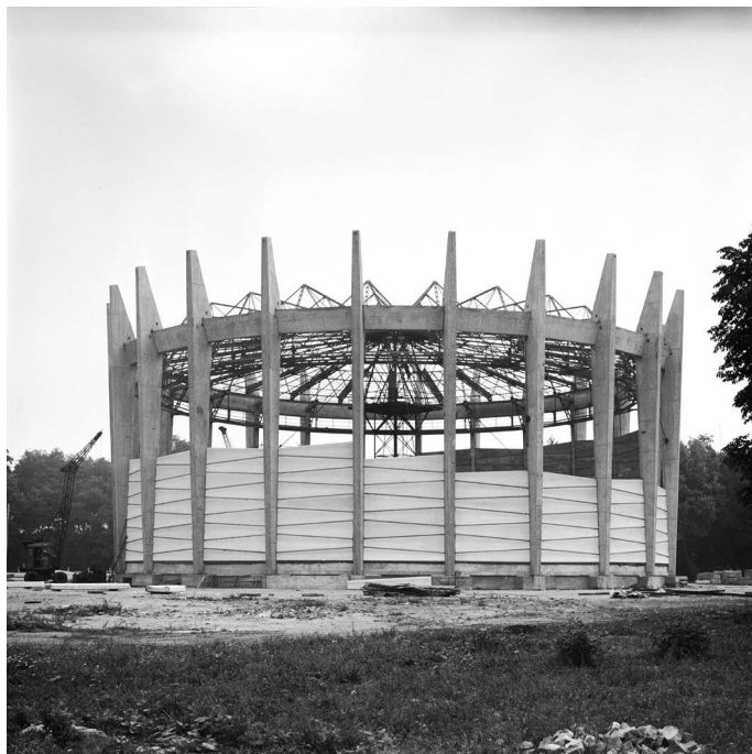
Il. 4. Budowa rotundy i montaż płyt ściennych, 1967 r., fot. Andrzej Osiński (źródło: Muzeum Architektury we Wrocławiu)
