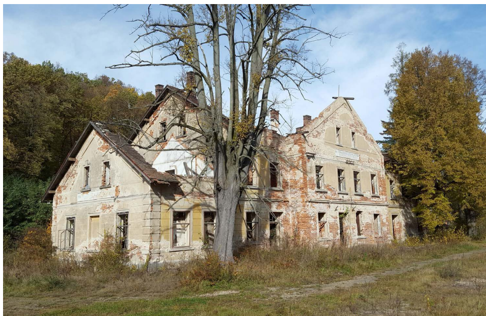
Il. 11. Ruiny budynku dworca na stacji granicznej w Hermanicach. 20 X 2021 r. Fot. Paweł Jakuboszczak.
